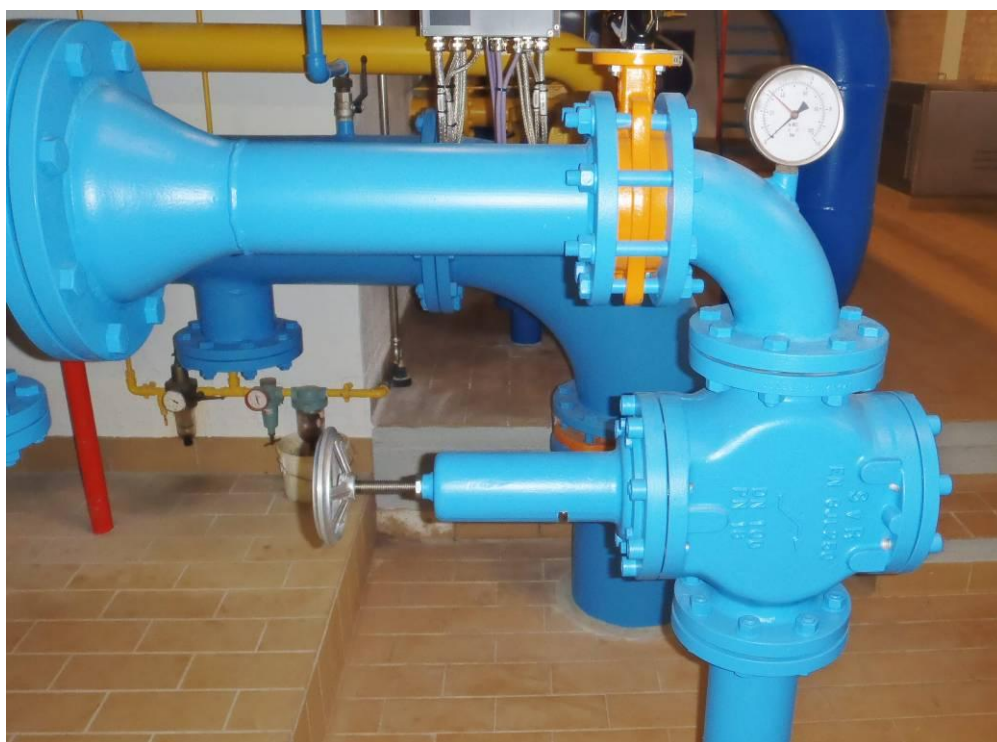
Ventil til manuel styring af rentvandspumpernes udgangstryk. Max. 3 bar. (30 meter vandsøjle)
