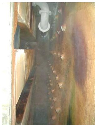
Indstøbte lerrør i væg for ind-sugning af luft til iltning af rå-vand.
