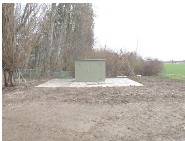
Nuværende kildeplads med erstatningsboring B6
