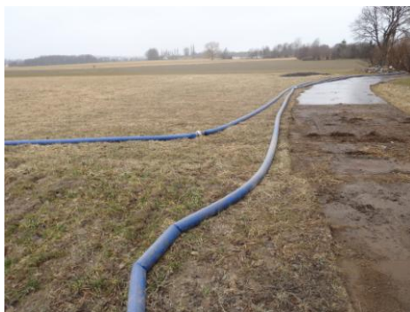
Afløbsledninger til og fra bundfældningsbassinet.
