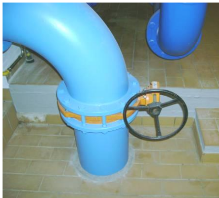
Afspærringsventil for afgangsrør fra reservoir.
