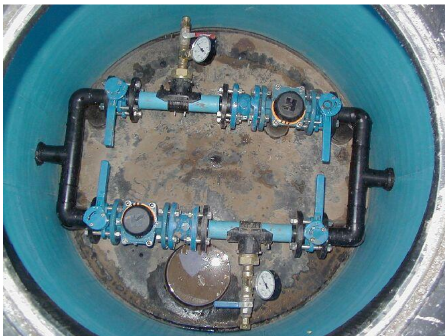
Kammer med afspærringsventiler, hovedmålere og trykmålere.
