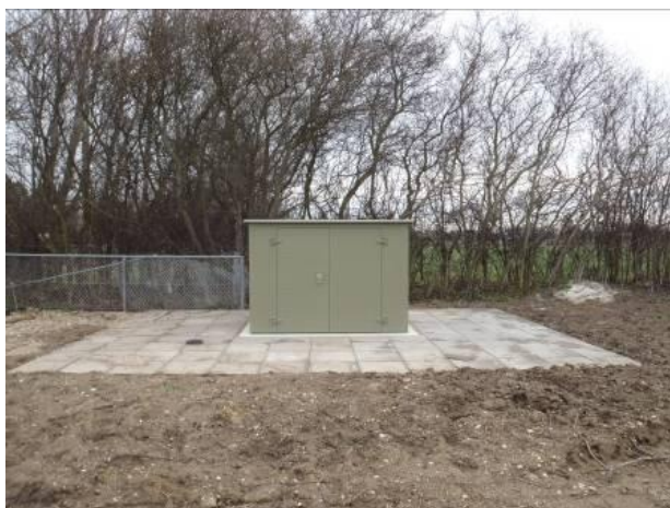
Råvandsstation for B7
