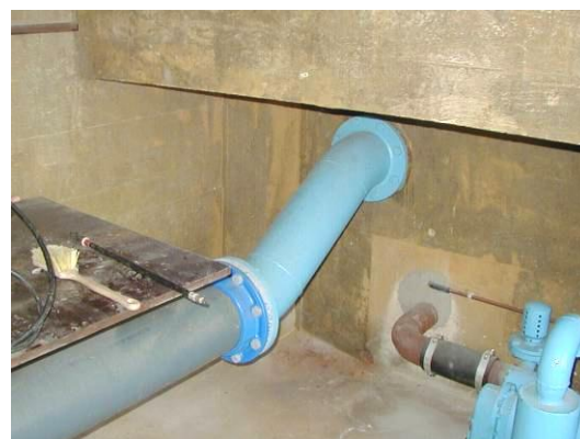
Rør til henstandstank. Røret er placeret i værkstedet.
