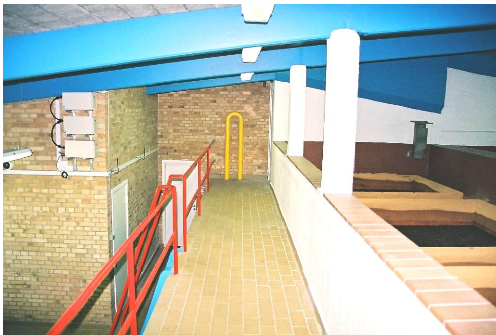
Tilsynsrampe omkring åbne sandfilterbassiner. I baggrunden ses sløjfe fra kapselblæser.
