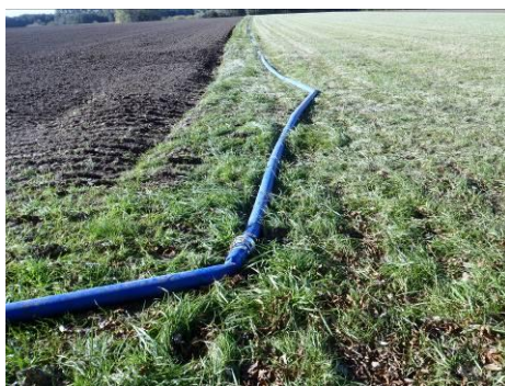
Afløbsledning drejer mod åen
