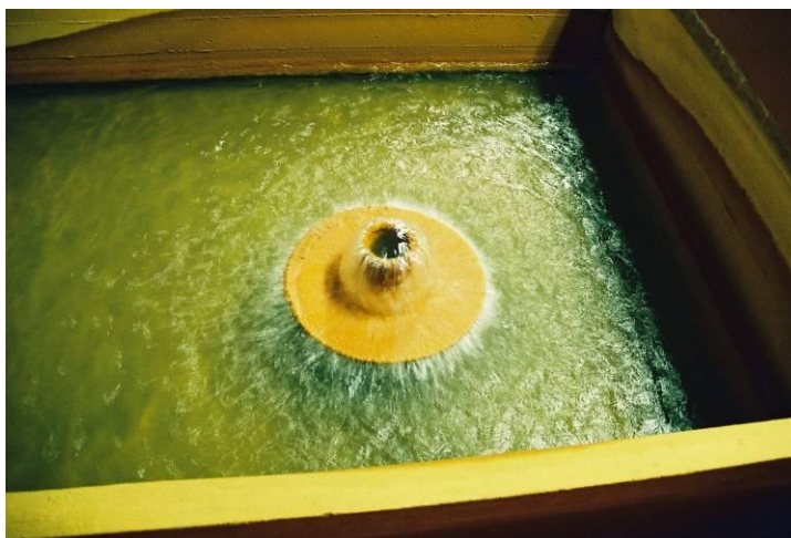
Normal driftsituation med udpumpning af iltet råvand over det ene af de seks sandfilterbassiner.
