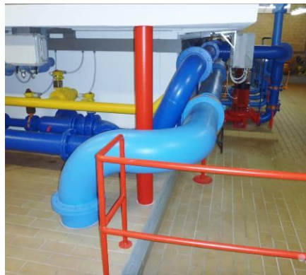
Afgangsrør fra reservoir.
