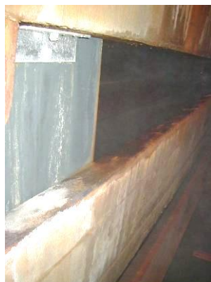
Åbning til iltningsbassin
