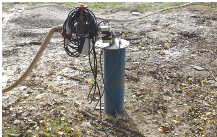
Forerør, hvorfra der prøvepumpes og udtages vandprøve.
