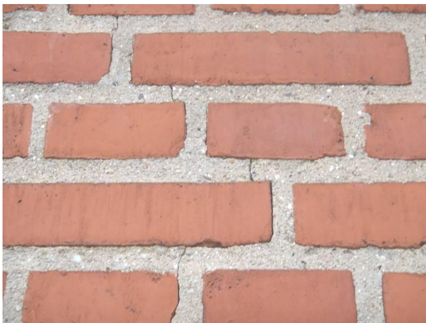
Revne i murværk. (Revnerne er udbedret i 2012)
