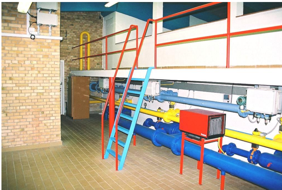
Lejder op til tilsynsrampe. NB: Mangler nedstyrtningsværn !
