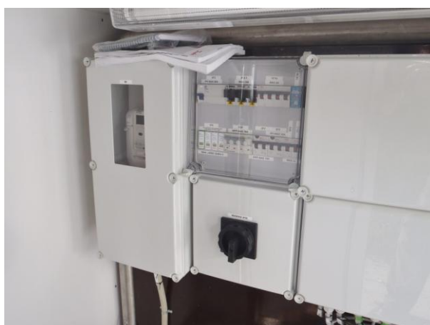
Panel med sikringer.
