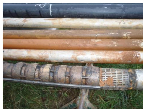
Dykpumpe med okkerbelægning.
