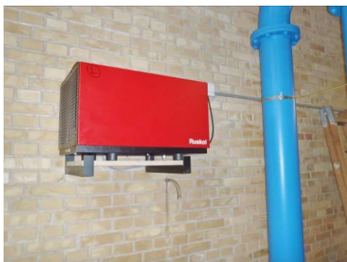
Affugter på væg ved rentvands-afgangsrør.
