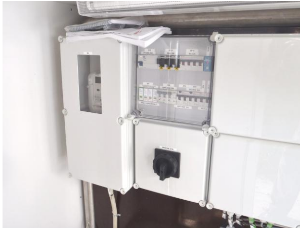
Panel med sikringer
