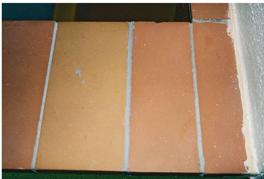
Klinkebelægningen på mur omkring sandfilterbassiner repareret i 2009 med dilatationsfuge af silicone. Klinkerne var sprængt løse, formentlig på grund af spændinger i jernbetonsøjlerne.
