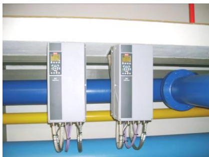
Frekvensomformere for rentvands pumperne nr. 2 og nr. 3.
