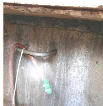
Udløb for bortpumpet kondensvand og lign.
