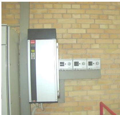
Frekvensomformer for rentvands- pumpe nr. 1.
