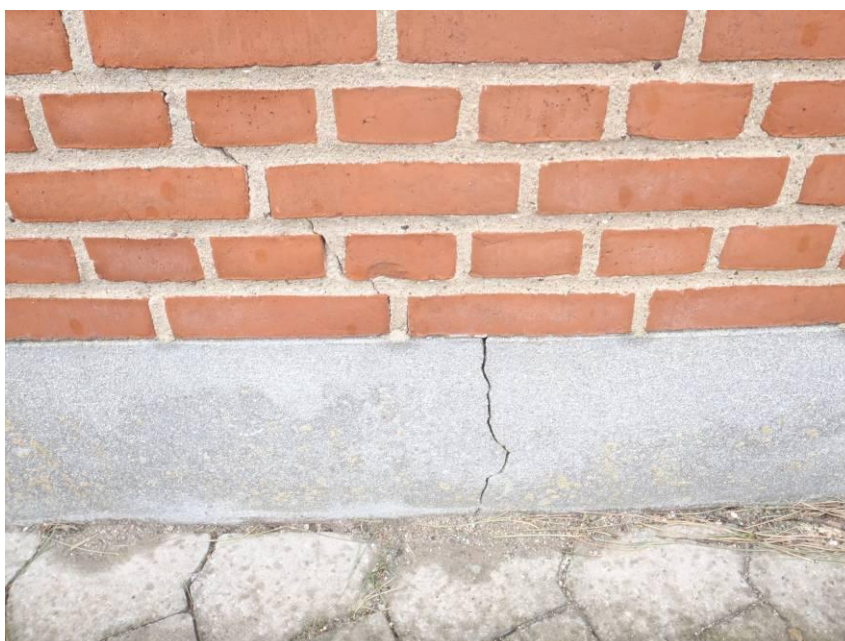
Sætningsrevne i fundament og op i murværk. (Revnerne er udbedret i 2012)
