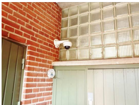
Videokamera ved indgang til kontor og maskinhal.
