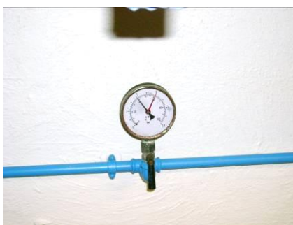
Manometer for måling af vandtryk i vandledning til bad og toiletrum.
