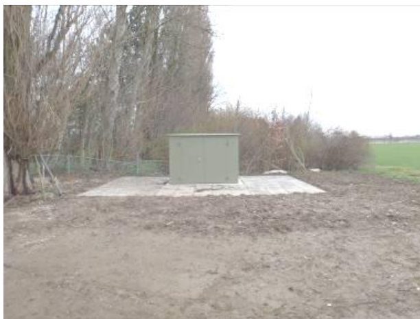
Råvandsstation for B6
