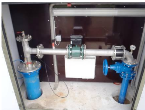
Interiør råvandsstation med teknik for til- og afgang af råvand.
