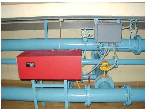
Affugter ved lejder op til de åbne sandfiltre.
